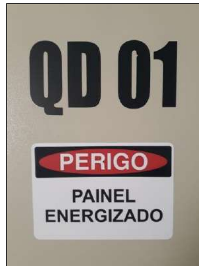
Figura 49. Identificação externa dos quadros.
