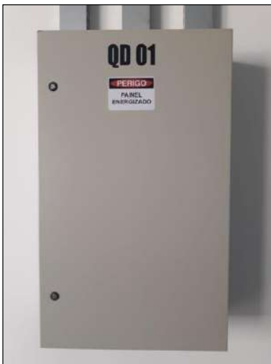
Figura 48. Identificação externa dos quadros.
