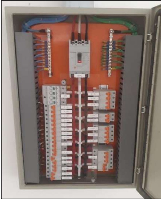
Figura 46. Identificação de circuitos.
